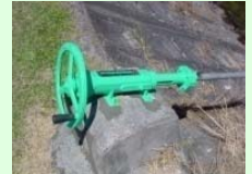
ゲート・バルブの更新
